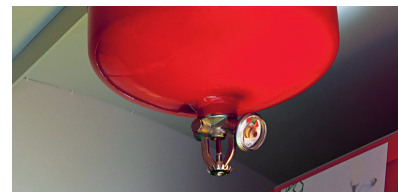
Sprinklersystem för ökad säkerhet.
