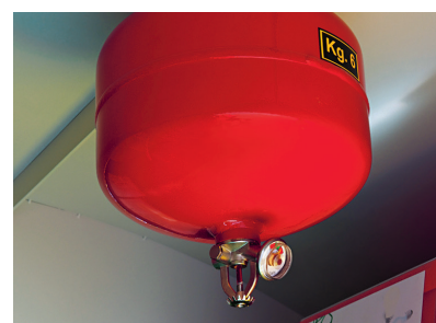
Sprinklersystem för ökad säkerhet.
